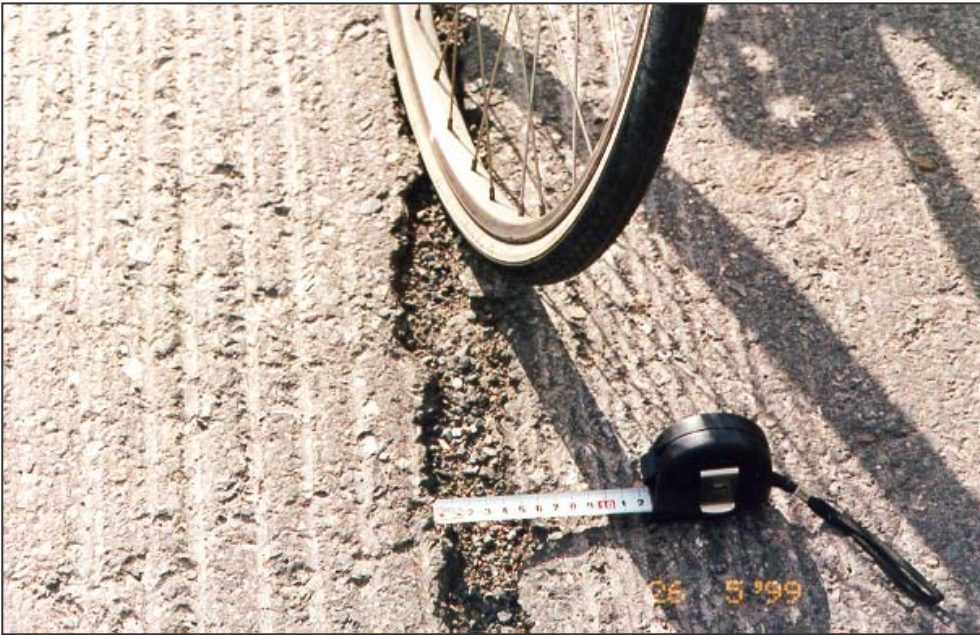
Kuva 3 . Tätä kesän alussa 1. kunnossapitoluokan kevyen liikenteen väylältä havaittua vaurioita (leveys noin 10 cm) ei paikattu koko kesänä (Oulu).
